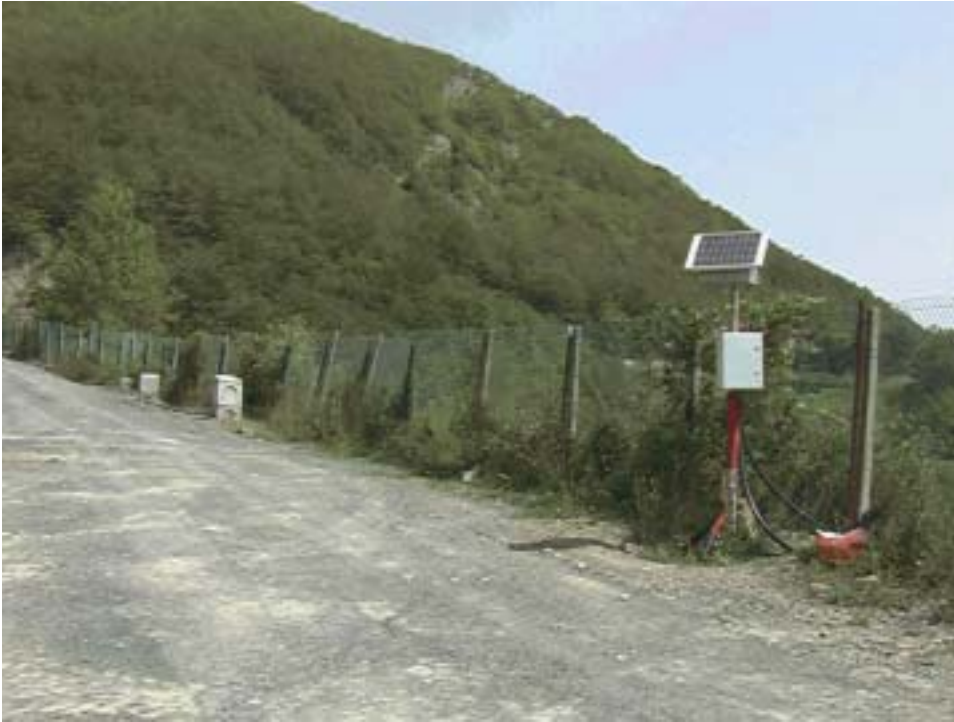
Centralina completata con l'installazione del pannello solare di alimentazione
